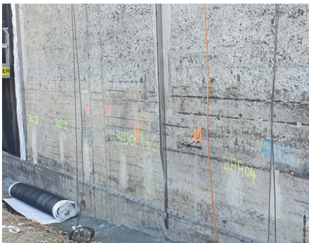
Abb. 9: Klemmleiste der KDB unterhalb der Bohransatzpunkte des Dichtungsschleiers
